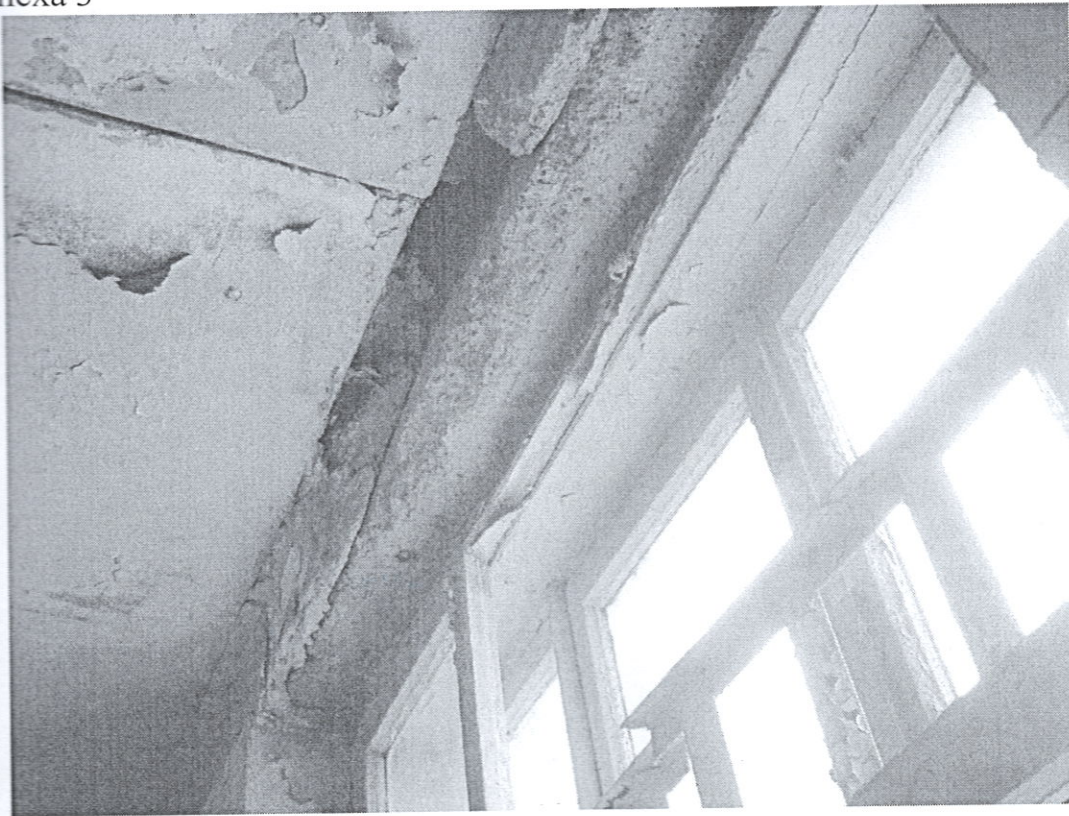
f: Anexa 3: Deformații și inconveniențe elemente structură.
