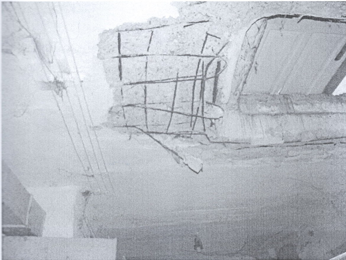
h: Anexa 3: Deformații și inconveniențe elemente structură.
